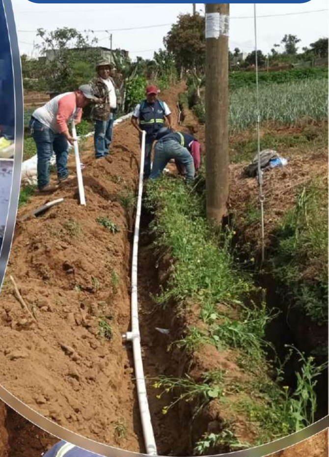
Introducción de agua potable
